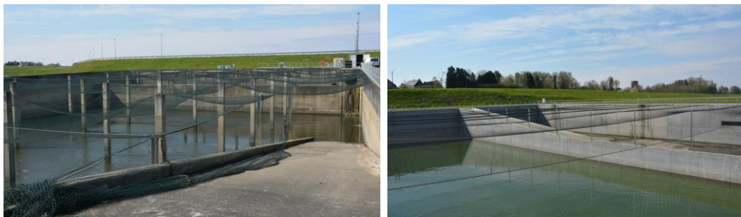
Figure 12 : Bassin d'orage nord (à gauche), bassin d'orage sud (à droite) (ARIES, 2023)
